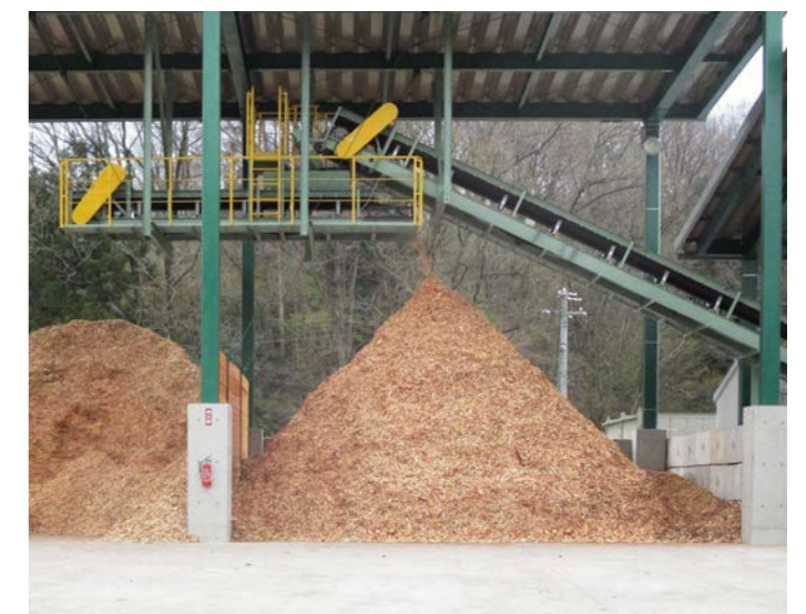
■ ヤードコンベヤ
