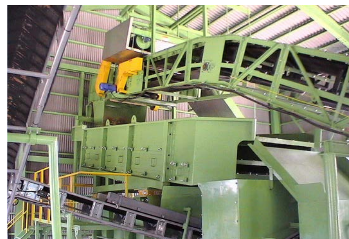
■ 排出コンベヤ・磁選機・旋回スクリーン
