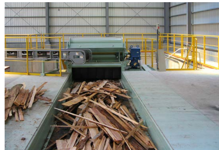
■ 投入コンベヤ
